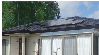
3.64kWシステム (栃木県)
