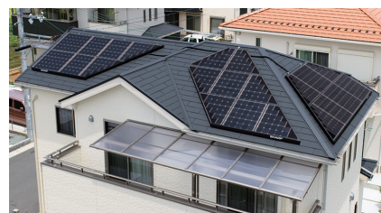
2.98kWシステム (奈良県)
